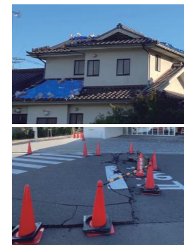
2021年2月の地震の被害状況
