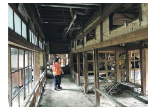
天井まで浸水した老舗旅館。修繕支援によって再建の希望を取り戻すことができました。
